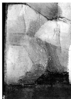
fig.4 絵具層の剥落状況
