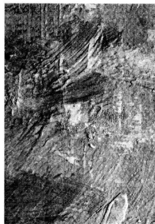
fig.8 剥落や亀裂部分にワックスが溜まっている状態
