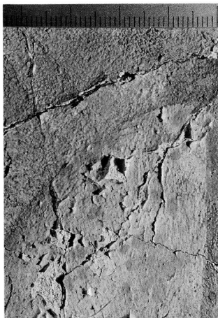
fig.13 《シルラ》浮き上がり部分(処置前)
