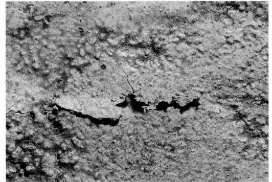
fig.4 《パリアフェ》支持体から浮き上がった漆喰層の状態
